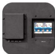
1. Клеммный блок 2. Автоматический выключатель
